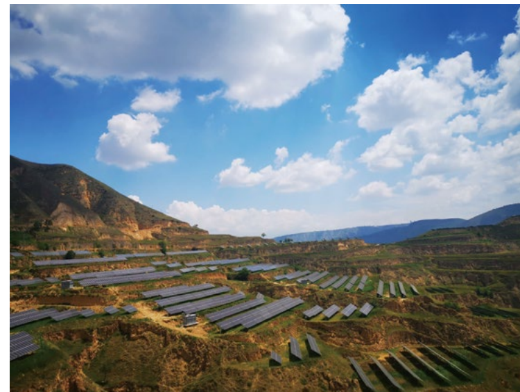
④ 东乡光伏发电项目
