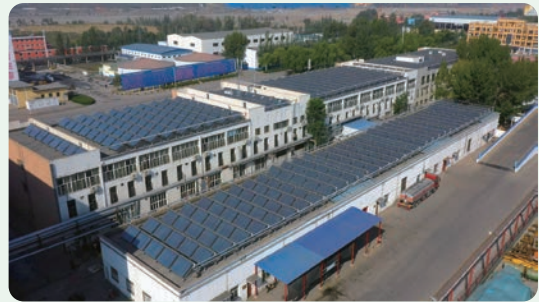
石圪台煤礦太陽能設備
