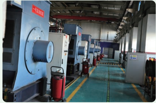
瓦斯發電機組
