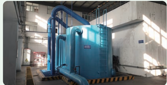
礦井水回用設備
