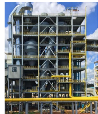
越南仁基氧化鋁工程項目——焙燒爐
