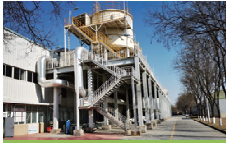
塗裝廢氣處置設施：沸石轉輪濃縮+RTO
