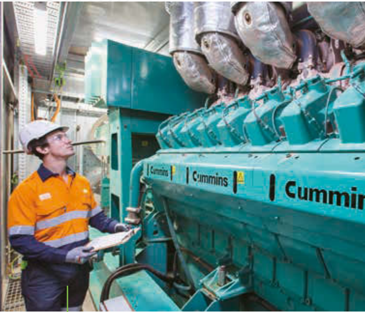
EDL在2020年完成擴建Agnew混合能源微電網，當中包括18兆瓦風力發電設施和13兆瓦儲電基礎設施。
