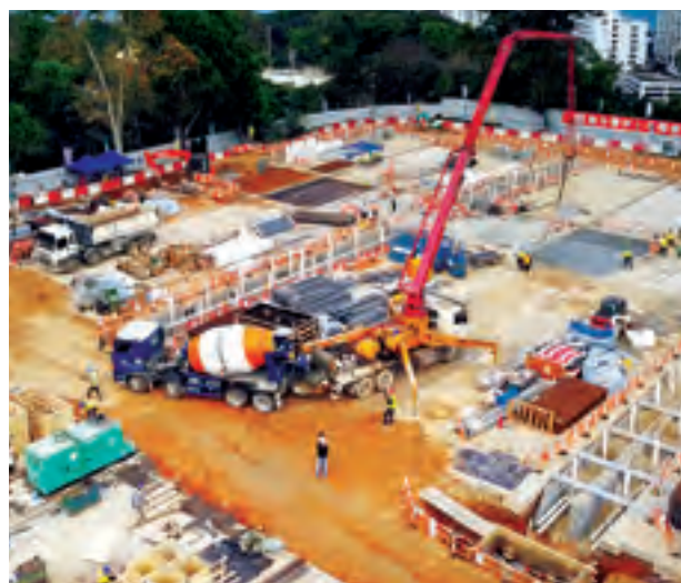
於二零二零年第一季當2019冠狀病毒爆發時，友盟為鯉魚門公園及竹篙灣兩個檢疫隔離營的興建工程，提供穩定且高質量之混凝土。
