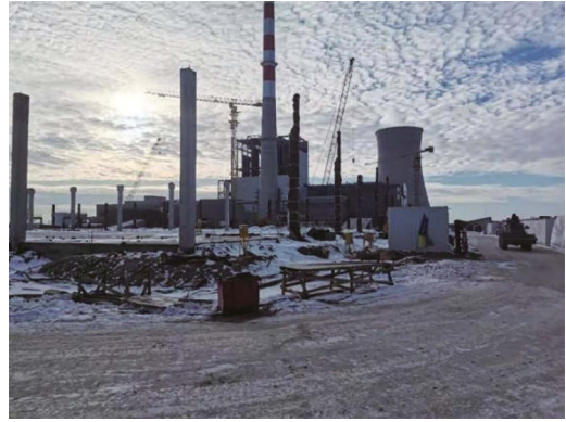
綏化市肇東2×40兆瓦生物質熱電聯產項目
