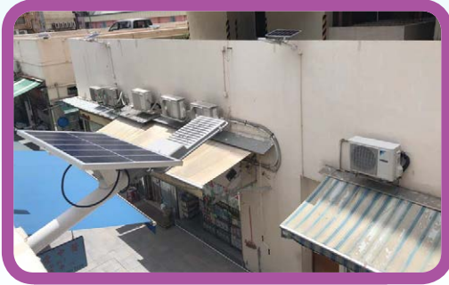
Solar Panels in Shun Fung Building 順豐大廈的太陽能電池板
