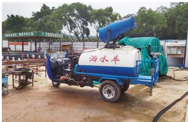
施工場地灑水防揚塵設備
