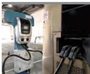
為推動電動巴士的發展，九巴在主要車廠裝設充電設施
