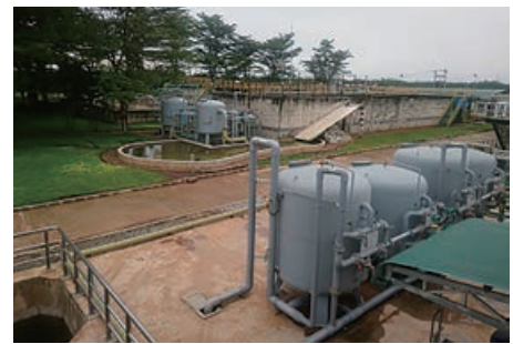
生物處理池與砂濾槽
