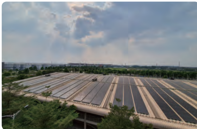
越南廠區的太陽能發電板 PV panels in the Vietnam factory area
