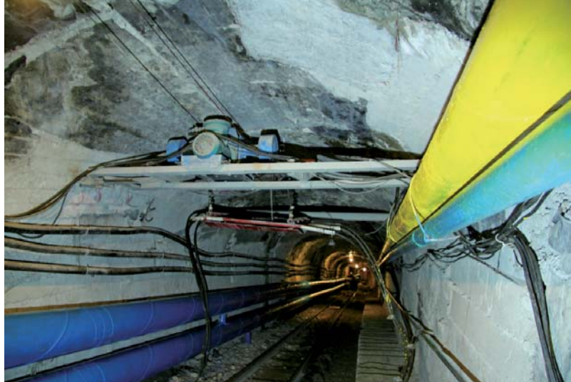
井筒防跑車裝置
