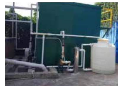
新增MBR膜生化池和废水检测设备
