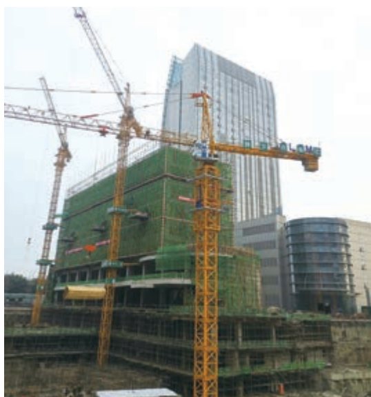
富豪國際新都薈之商業/寫字樓大樓 — 地庫及上蓋建築工程現正進行中
