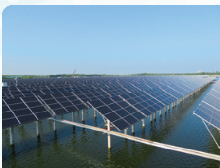
山東省微山縣集中式光伏發電站
