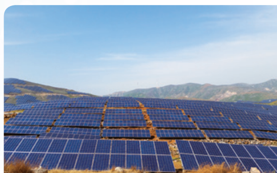
河南省淇縣廟口集中式光伏發電站
