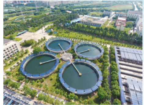
廣東省東莞市北控水務集團水廠內的分佈式光伏發電站
