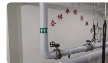
項目配有加壓供水泵站，致力提供安全供水、優質服務
