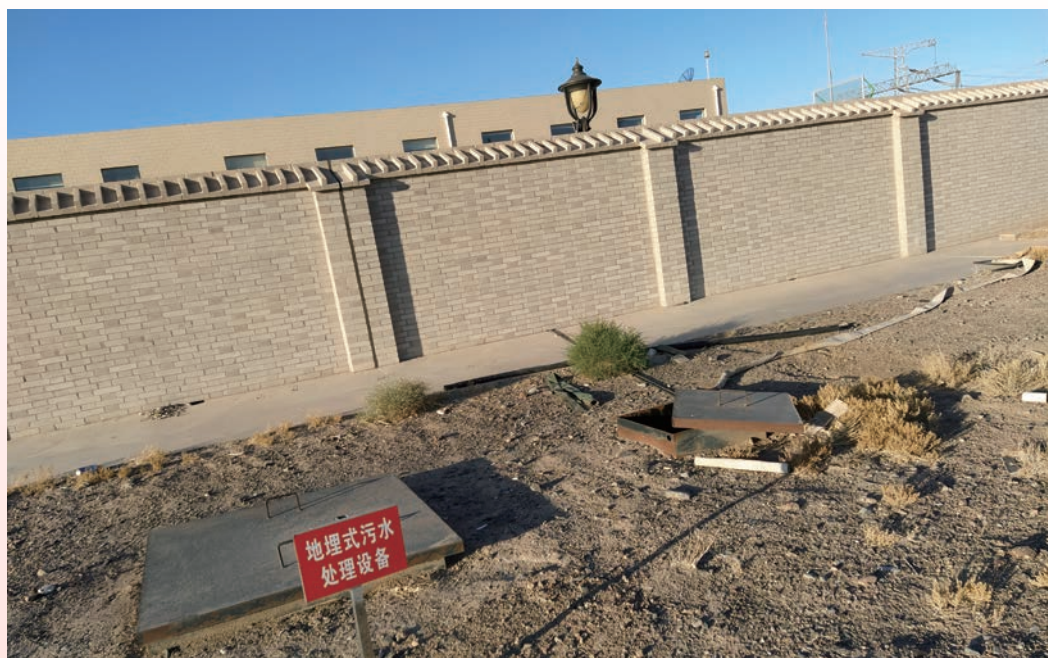
大唐新能源甘肅分公司生活污水處理裝置
