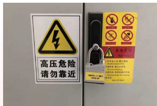
大唐新能源福建分公司櫃門安全標識
