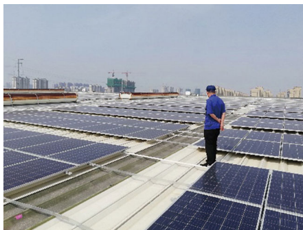
光伏發電系統
