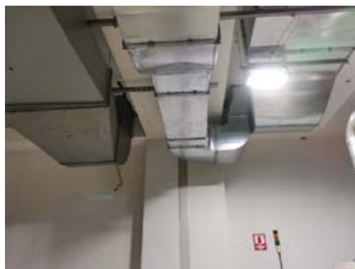
CMTR-1工廠地下室通風裝置
