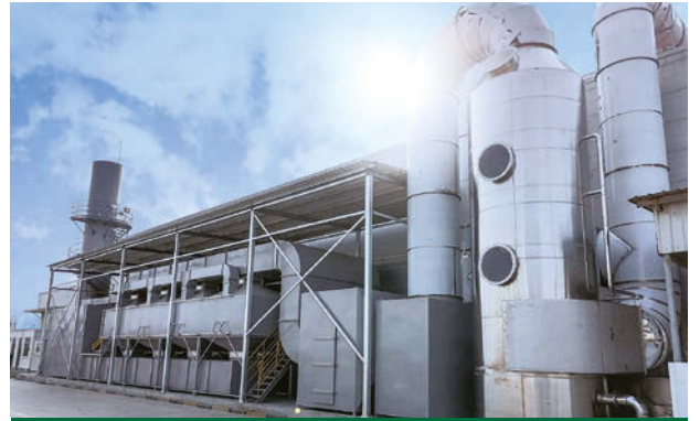
紛美山東工廠揮發性有機物治理設施已投入使用
