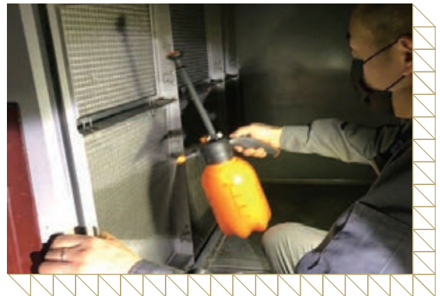
消毒空調過濾器
