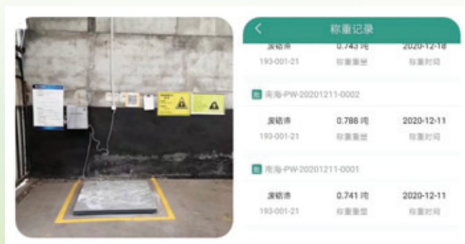
新增的危險廢物稱重裝置及危險廢物管理平台介面
