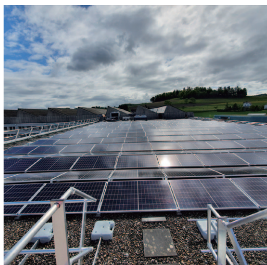
本集團在瑞士穆爾滕 (Murten) 的廠房屋頂上安裝了900平方米的光伏電池，每年估計可發電123兆瓦時。
