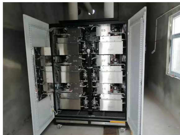
分佈式燃氣供熱業務設備
