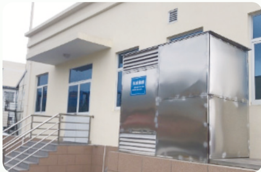
碼頭集團於國貿碼頭建設污水處理站，同時具備處理生活污水和含油生產廢水功能。
