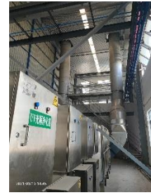
噴漆廢氣 UV 光解及高空排放
