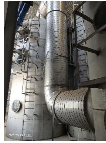
噴漆廢氣噴淋塔
