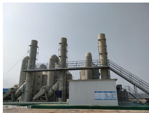
酸霧廢氣處理設施
