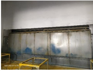
噴漆廢氣水簾收集
