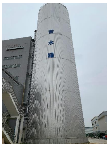
儲水罐 - 蓄冷／空調設備
