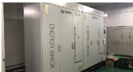
吾盛能源儲能設備
