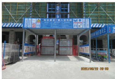
蕪湖新城大都會項目，樓層電梯防護棚及安全通道採取定型化搭設，有效抵擋高空墜物。
