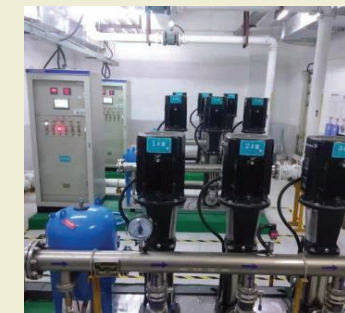
水泵房採用變頻無負壓系統
