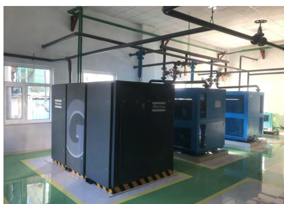
空壓機節能升級改造
