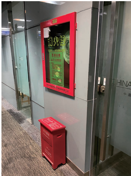
在中亞烯谷深圳辦公室安裝的消防設備
