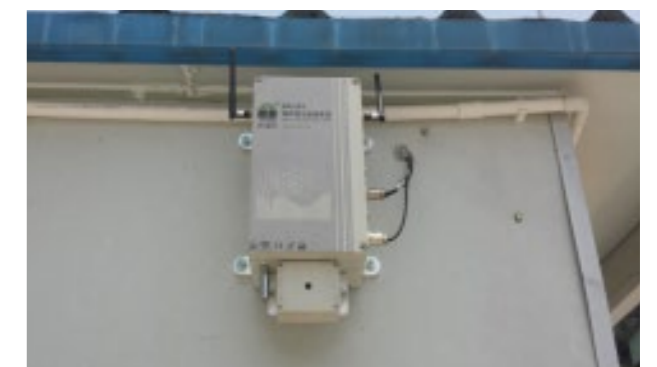
噪聲、揚塵監控系統
