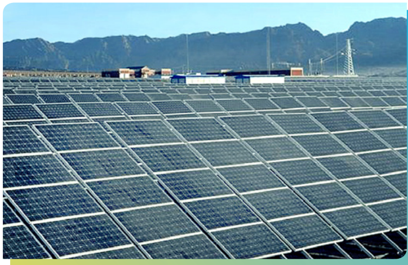
錫鐵山光伏發電項目
