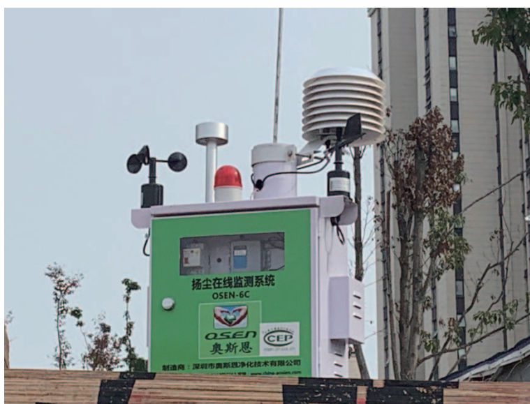
設置於工地的空氣質素監測系統
