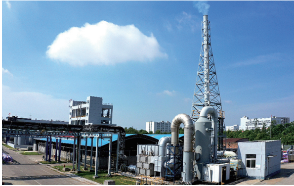
蓄熱式氧化爐(RTO)用於廢氣處理
