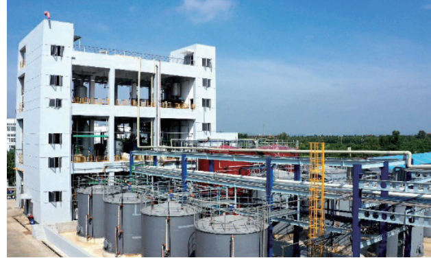
廢水預處理車間
