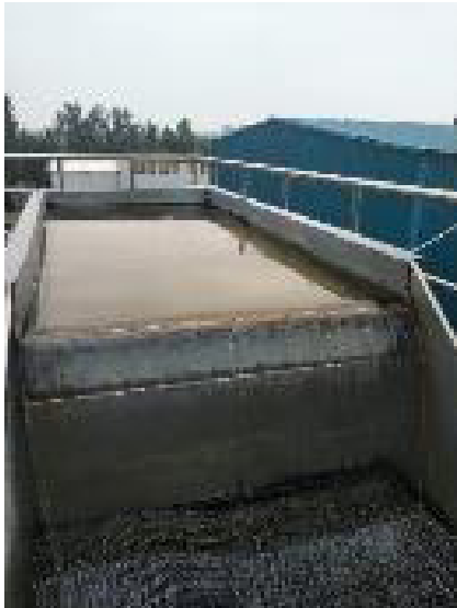
Wastewater Treatment 污水處理
