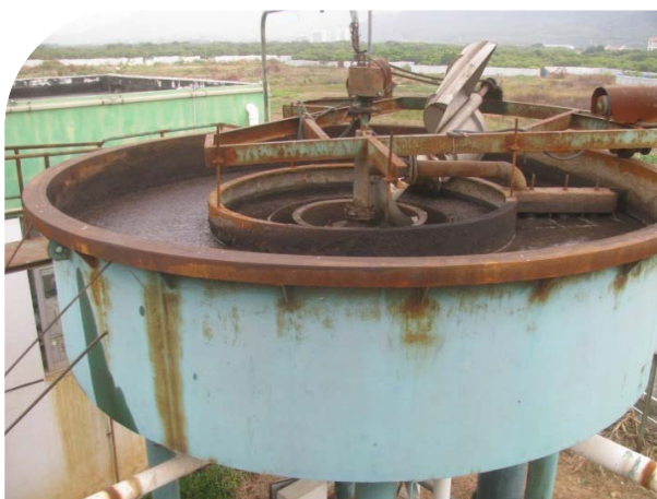
廢水過濾及處理系統
