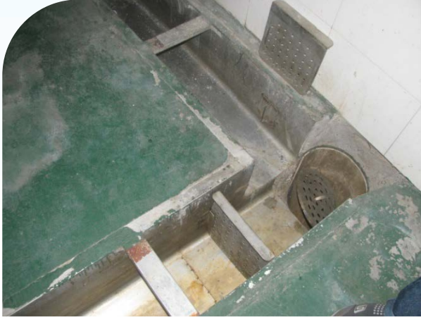
屠宰場內排放廢水的排水溝
