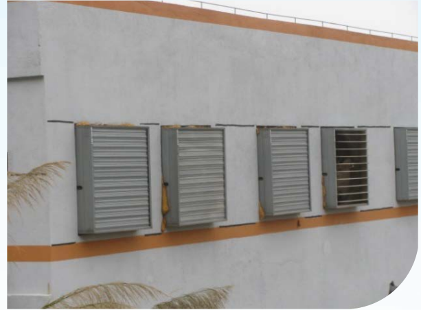
養豬欄排氣扇
