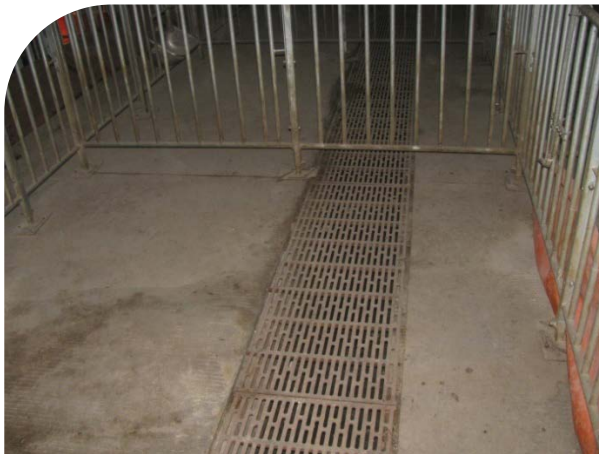
養豬欄內用於排放廢水的排水渠
