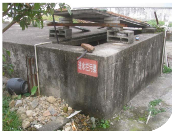
廢水過濾及處理系統
