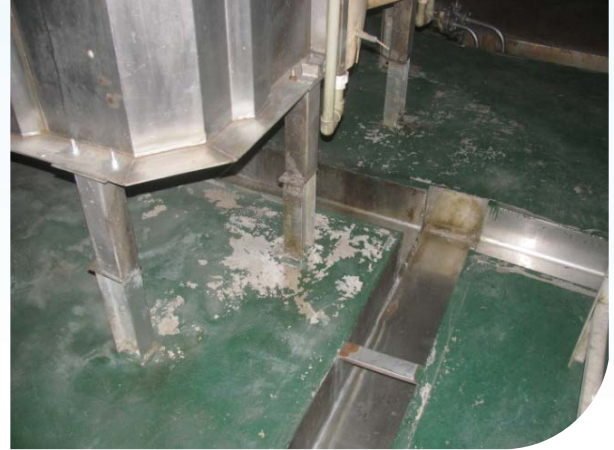
屠宰場內排放廢水的排水溝
