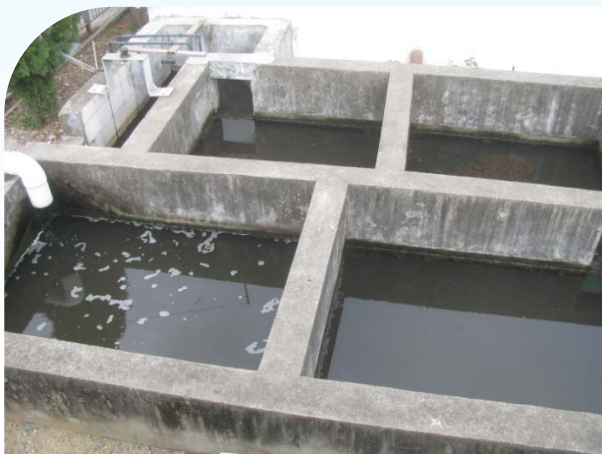
廢水過濾及處理系統
