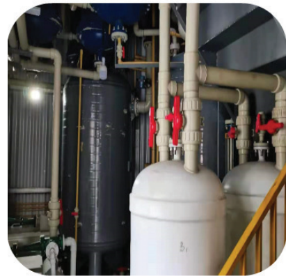
廢酸回收再利用裝置
