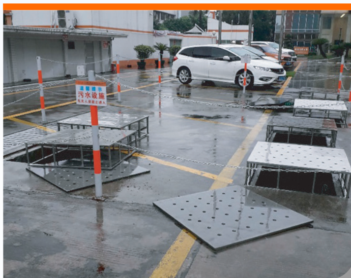
上圖為污水沉澱池(左)和污水設施(右)。
