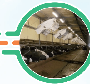
大風機 Big wind turbines
