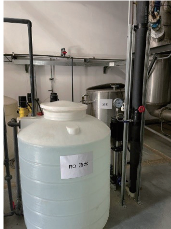
廢水處理站反滲透系統過濾清水回用
