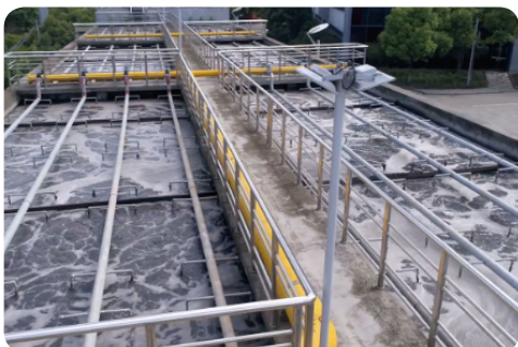
污水處理系統有效減少廢水及增加廢水循環使用
