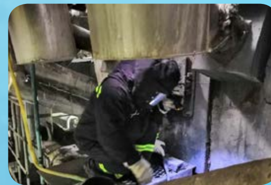
3. 檢修人員檢查確泄漏點
