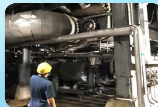
1. 巡檢人員發現泄漏
