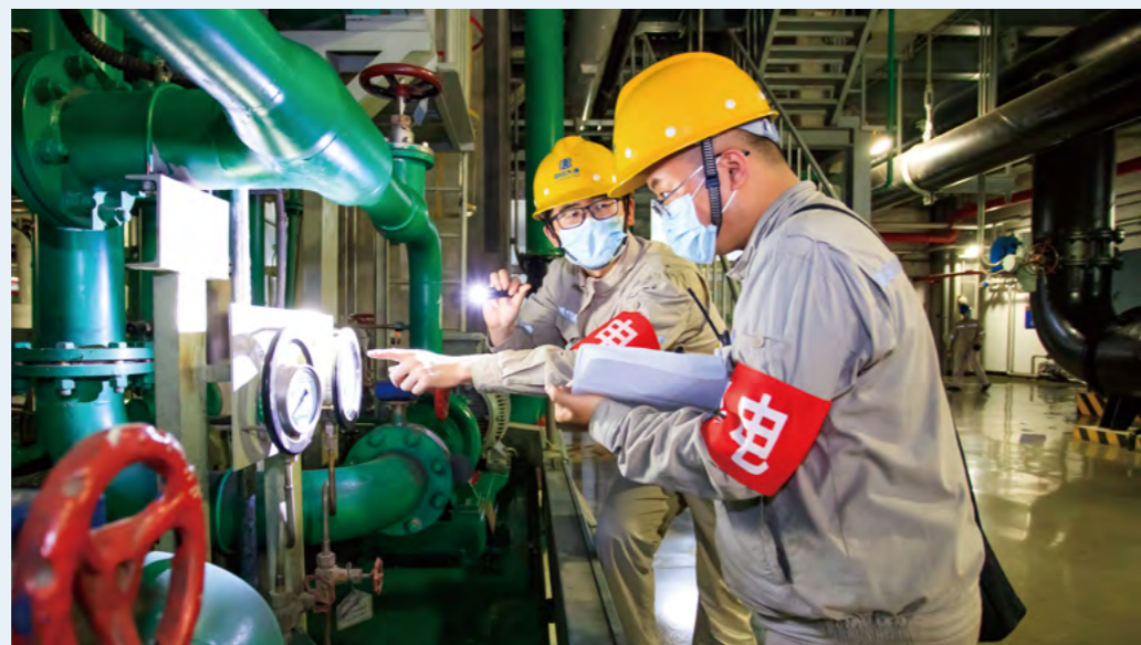
内蒙古托克托发电公司加强设备巡视检查
