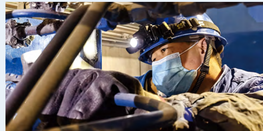
河北张家口发电厂维护设备安全为冬奥保电
