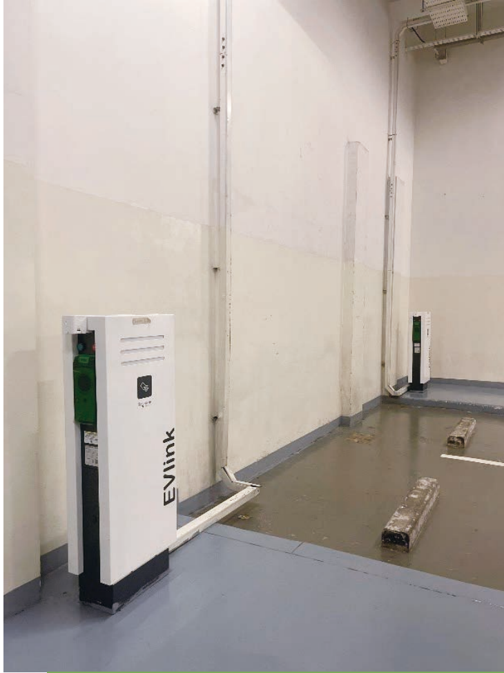
PCP Jakarta 電動車充電設施
