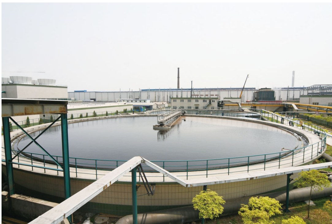
Sewage treatment station 污水處理站
