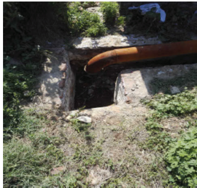
一分廠總排口封堵照片
