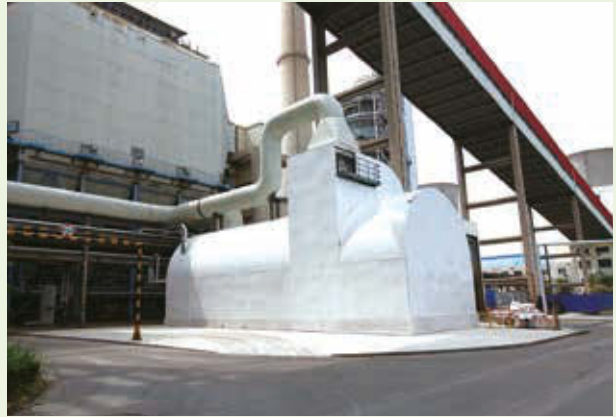
運河電廠燃煤耦合污泥發電項目
