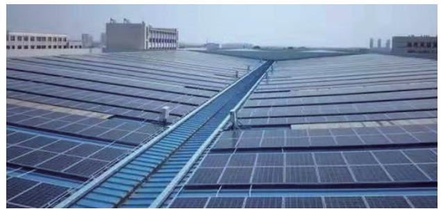
屋頂光伏發電
