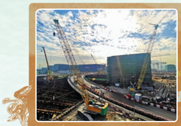
機場島上無人駕駛車 及行李輸送隧道
